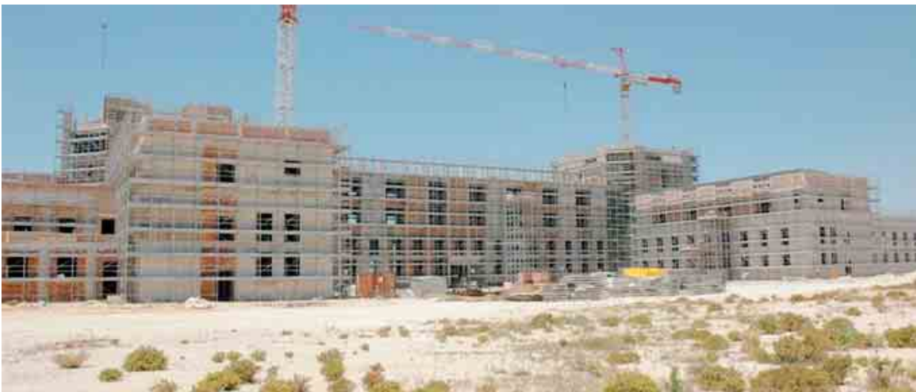
L'imponente struttura del monoblocco è stata sottoposta a severi controlli per verificarne la tenuta sismica e la qualità del calcestruzzo
